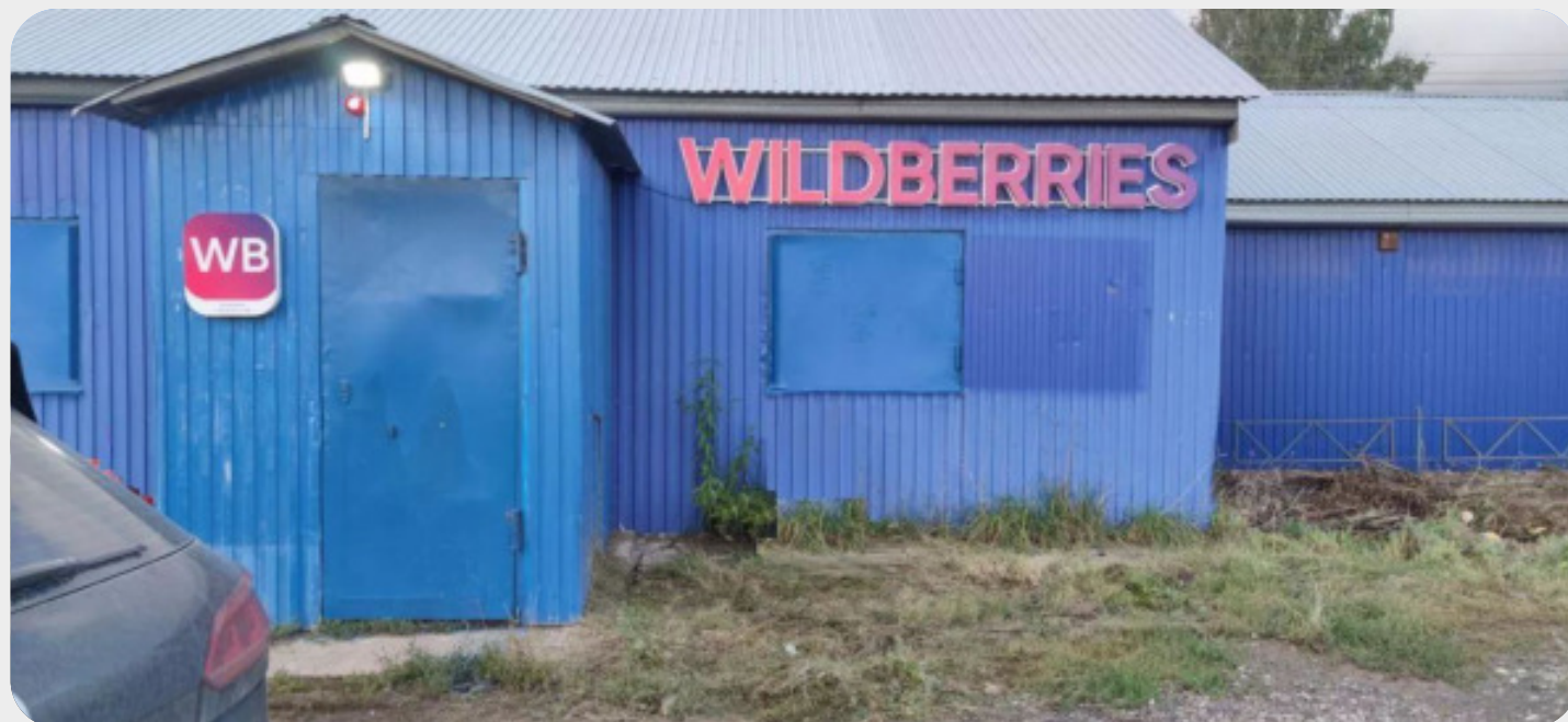
В здании с фасадом в плохом состоянии
