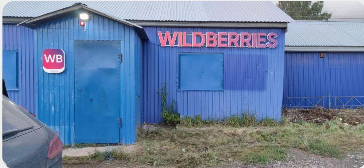
В здании с фасадом в плохом состоянии
