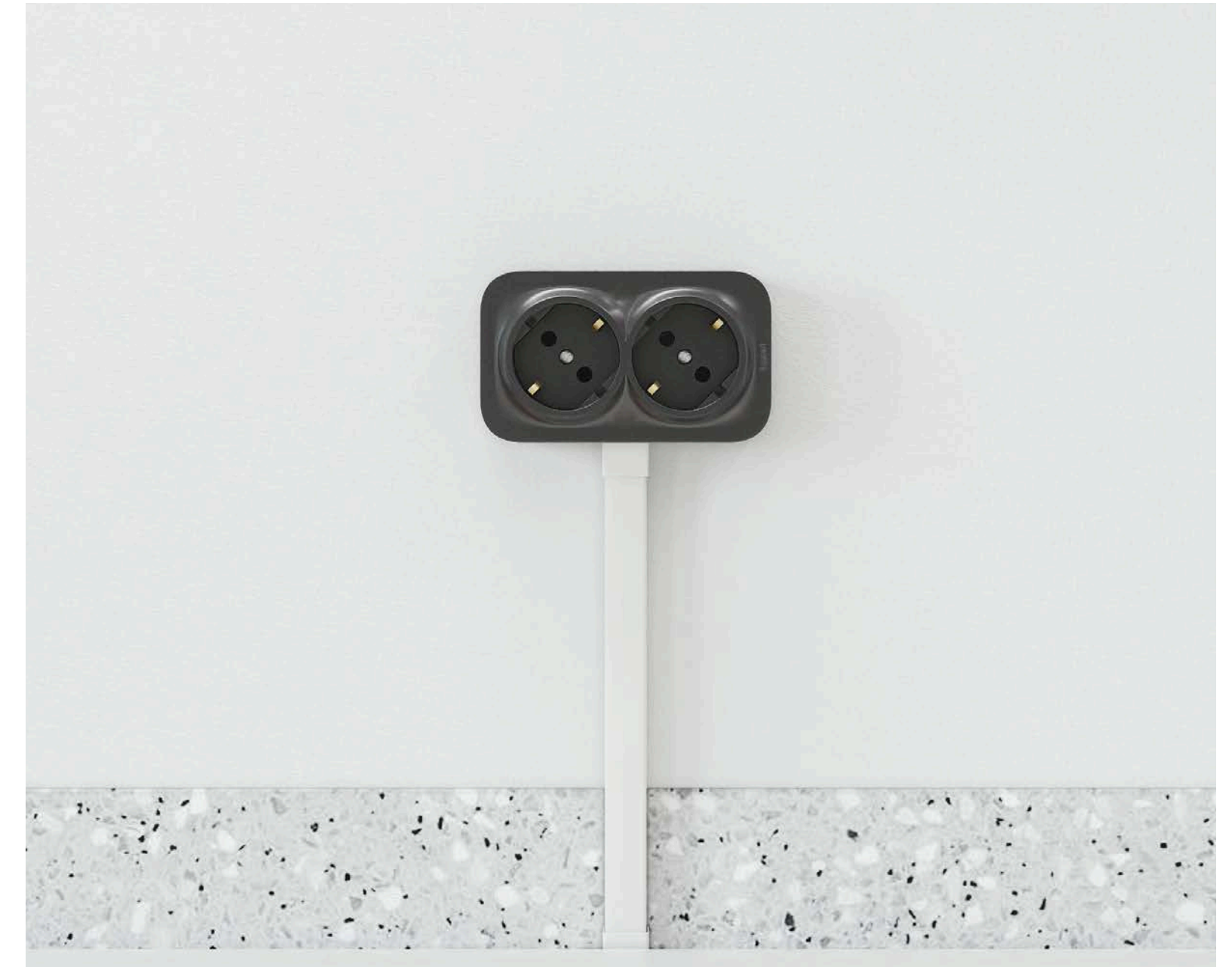
Открытая электрика с пола
