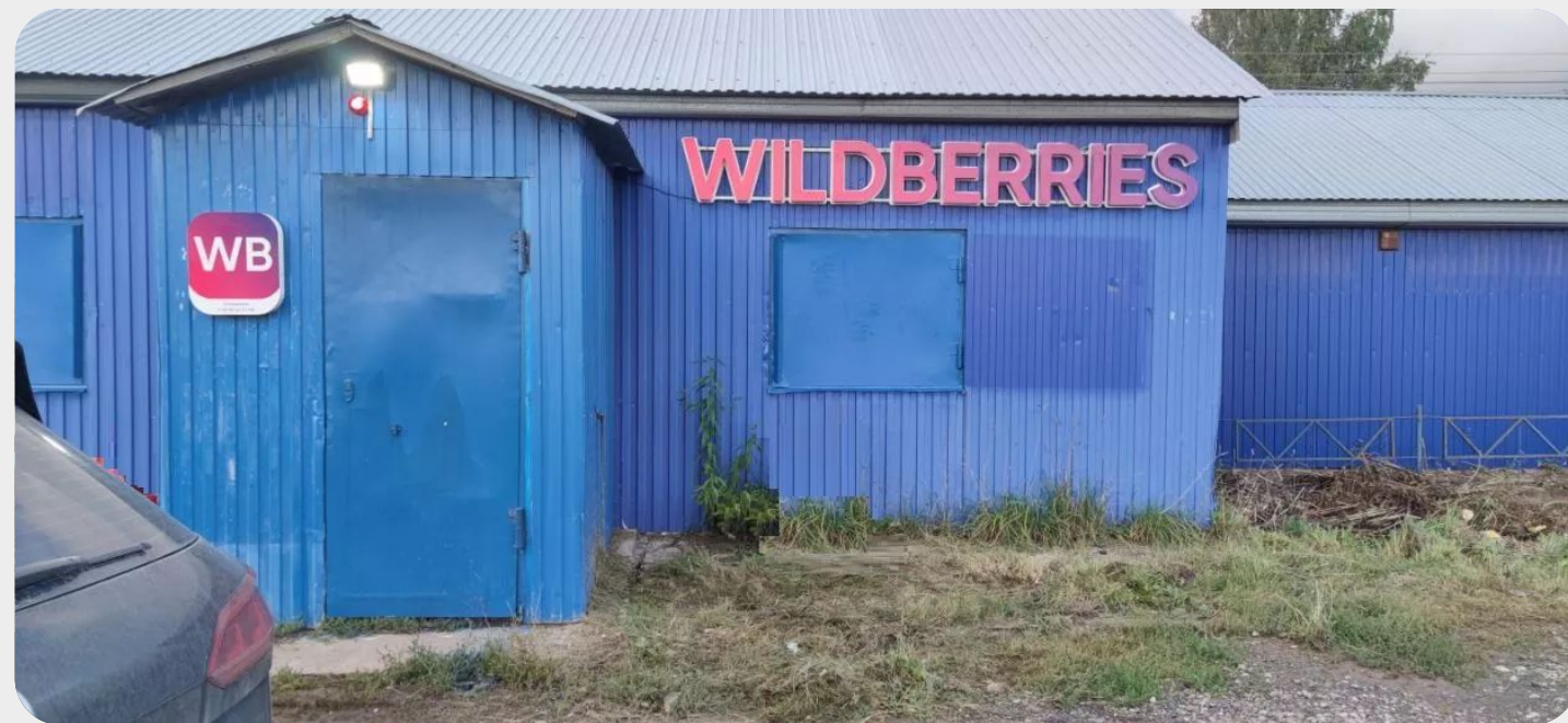
В здании с фасадом в плохом состоянии
